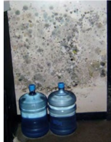
Crecimiento de moho en placas de pared
