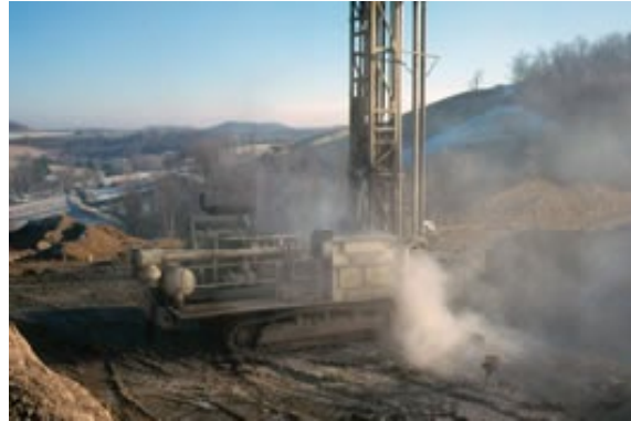
Figura 1 Perforación de rocas sin control de polvo adecuado.
