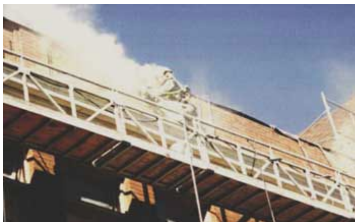
Figura 1 Extracción del mortero sin ningún tipo de control, con lo que se genera la exposición peligrosa al polvo.
