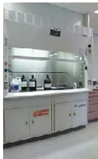
Figure 8. Hotte de laboratoire de chimie (notez que la zone de travail est à l'intérieur de la hotte)
