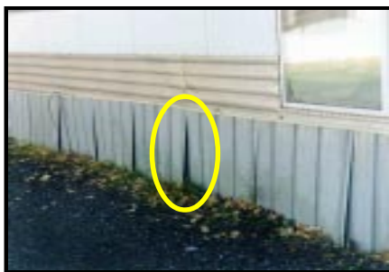
Arregle los huecos en los zócalos de los trailers
