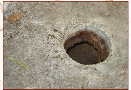
Pozo séptico abierto
