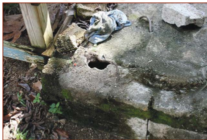
Tapa del pozo séptico rota
