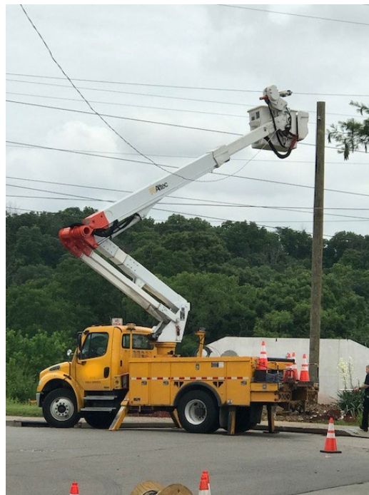
Foto 4. Posición del camión grúa en la calle sin salida al momento del incidente. Cortesía de la ciudad
