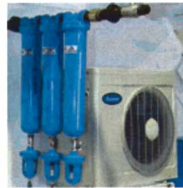
Air Scrubbers, exterior Air Con unit
