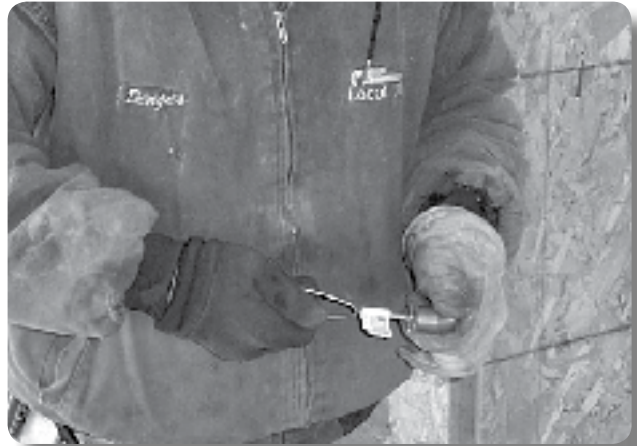
Problema: Cepillado manual de tubos de cobre
