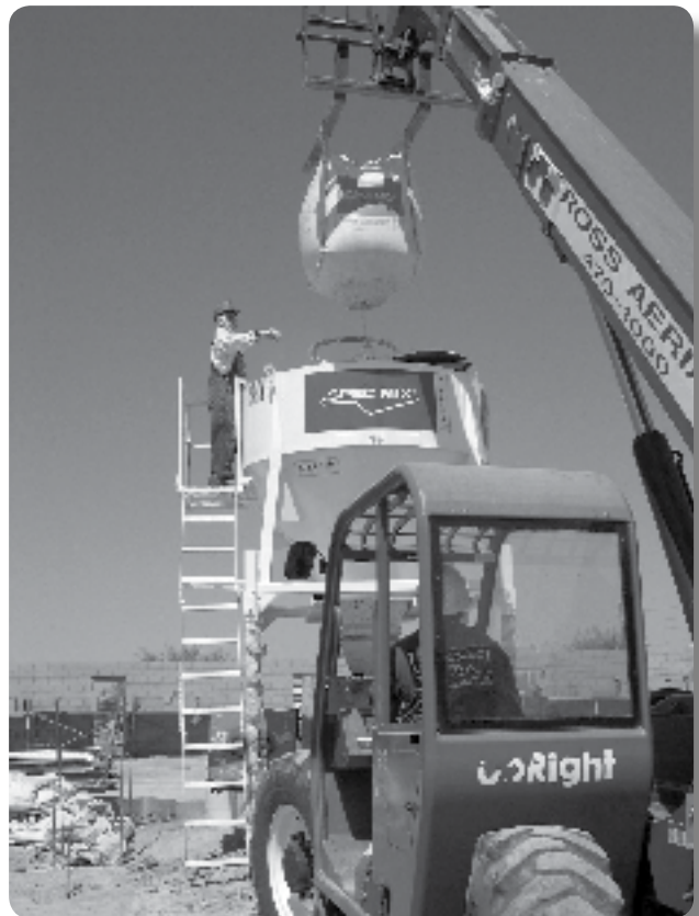
Solución: Carga de un sistema de silo
