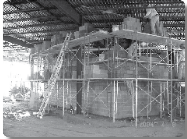
Problema: Andamio convencional sin estructura de protección
